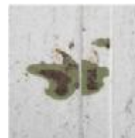
Mechanische Beschädigungen blieben ohne Unterwanderungen.
