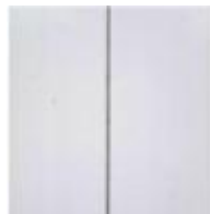
Nach 25 Monaten sind an den Sicken keine Blasen erkennbar.
